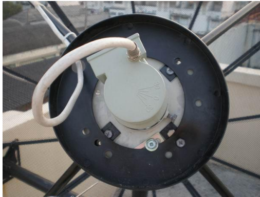
(รูปที่ 5 รูปแสดงการติดตั้งหัว LNB)
